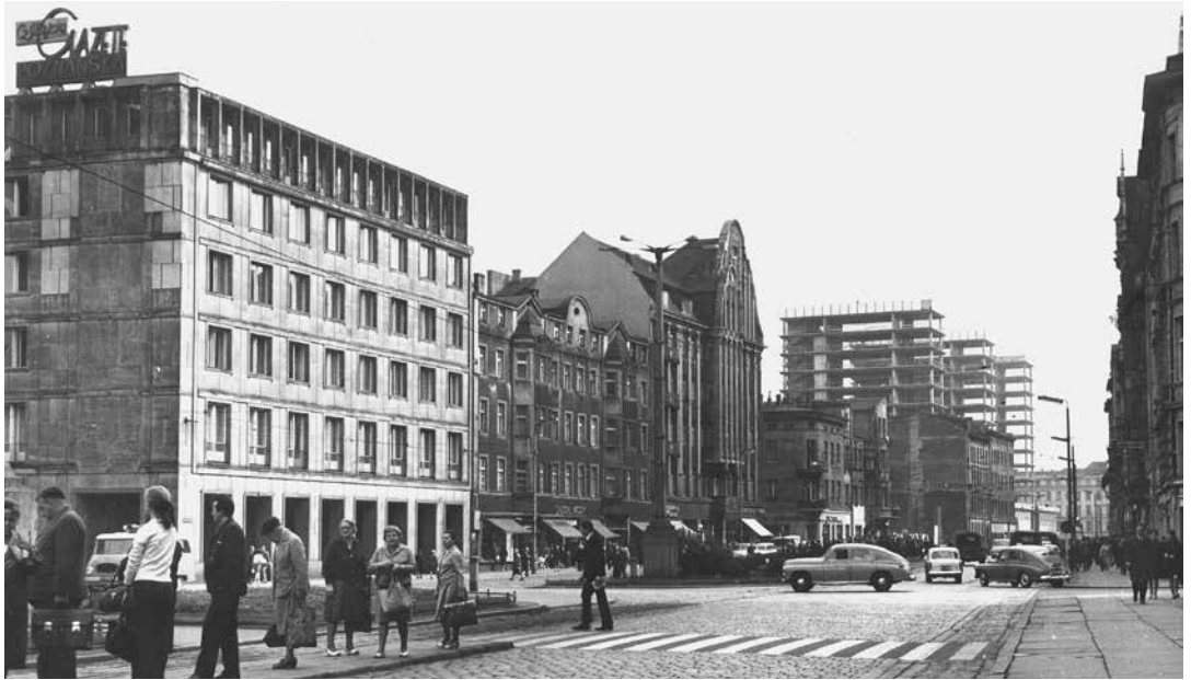
7. Budowa zespołu handlowo-biurowego „Alfa”, 1968 (MKZ. Fot. M. KucharSKI) 7. Construction of the shopping and office complex “Alfa”. 1968
